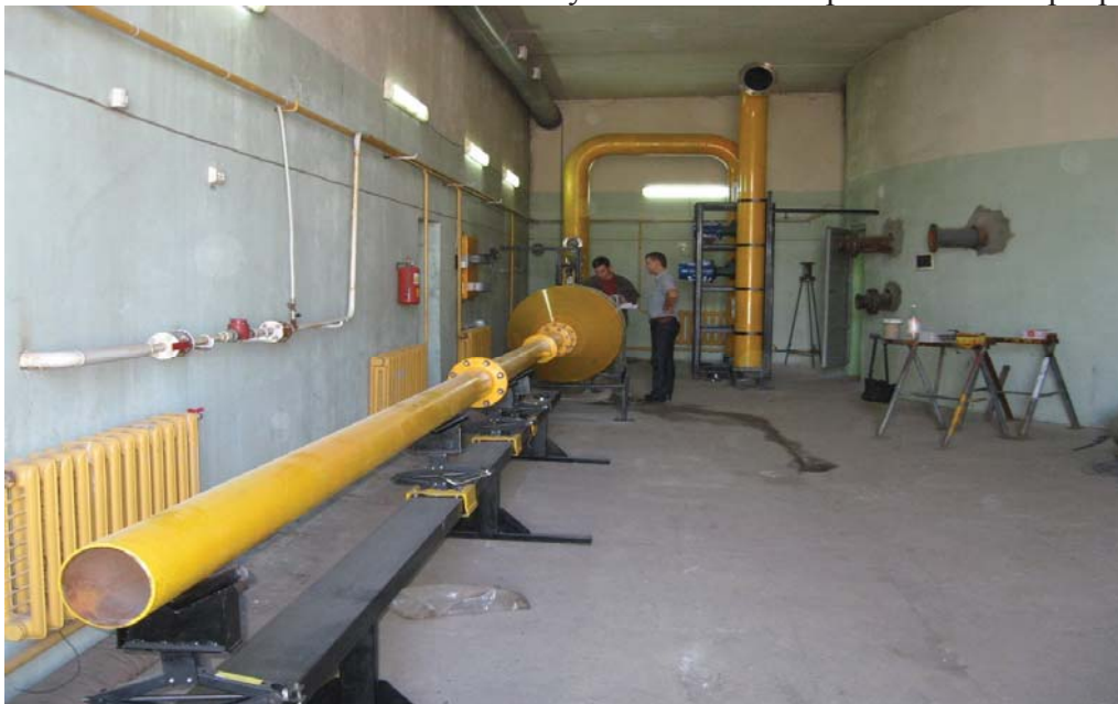
Рис. 2. Стенд, оснащённый воздухоудовками Рутса
