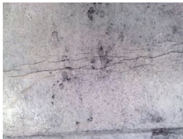
Рис. 1. Дефекты КРН в виде колонии трещин, выявленные магнитопорошковым методом контроля
