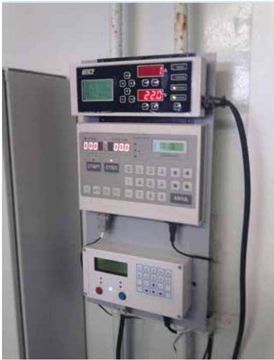
Рис. 2. Пульт гальванической установки для нанесения электрохимических покрытий на асимметричном переменном токе
